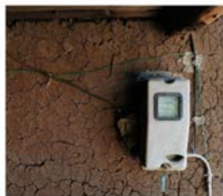
Figuras 7. Medidor de electricidad sobre muro de barro. Fuente: Amparo Prieto. Trabajo de campo. Colbún, Chile.
